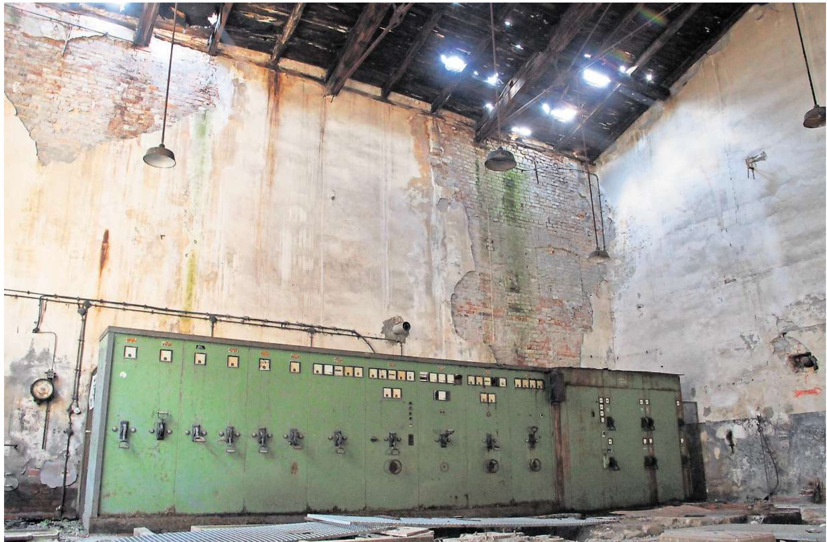
Kaputte Dächer stellen für die Bausubstanz in Hohenhofen eine große Gefahr dar. Daher müssen sie dringend erneuert werden. ARCHIVFOTOS (2): ANDRÉ REICHEL
