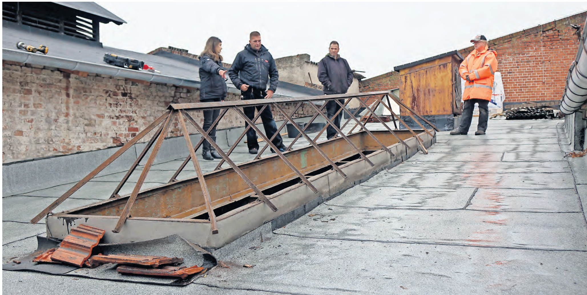
In der Industriearbeit Papierfabrik Hohenofen haben Restauratoren mit der Arbeit begonnen. Auch Dachdecker sind im Einsatz.
